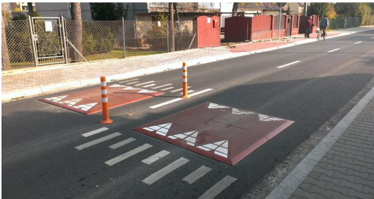
Ilustracja 3: Progi wyspowe (poduszkowe) przyjazne dla rowerzystów oraz komunikacji zbiorowej.
