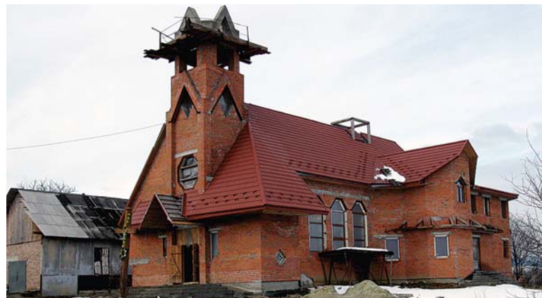
Borysław, Ukraina: budowa kościoła pw. Matki Bożej Nieustającej Pomocy wraz z zapleczem duszpastersko-katechetycznym; w głębi – część dawnej kaplicy, po pożarze adaptowana na magazyn budowlany. Stan: marzec 2009 r.
